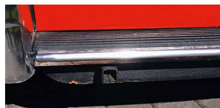
La pedana laterale (retaggio degli anni '30!) è in un punto intaccabile dalla ruggine e su questo esemplare ha richiesto un intervento di ripristino. In foto si vede anche il punto di sollevamento per il crick.
